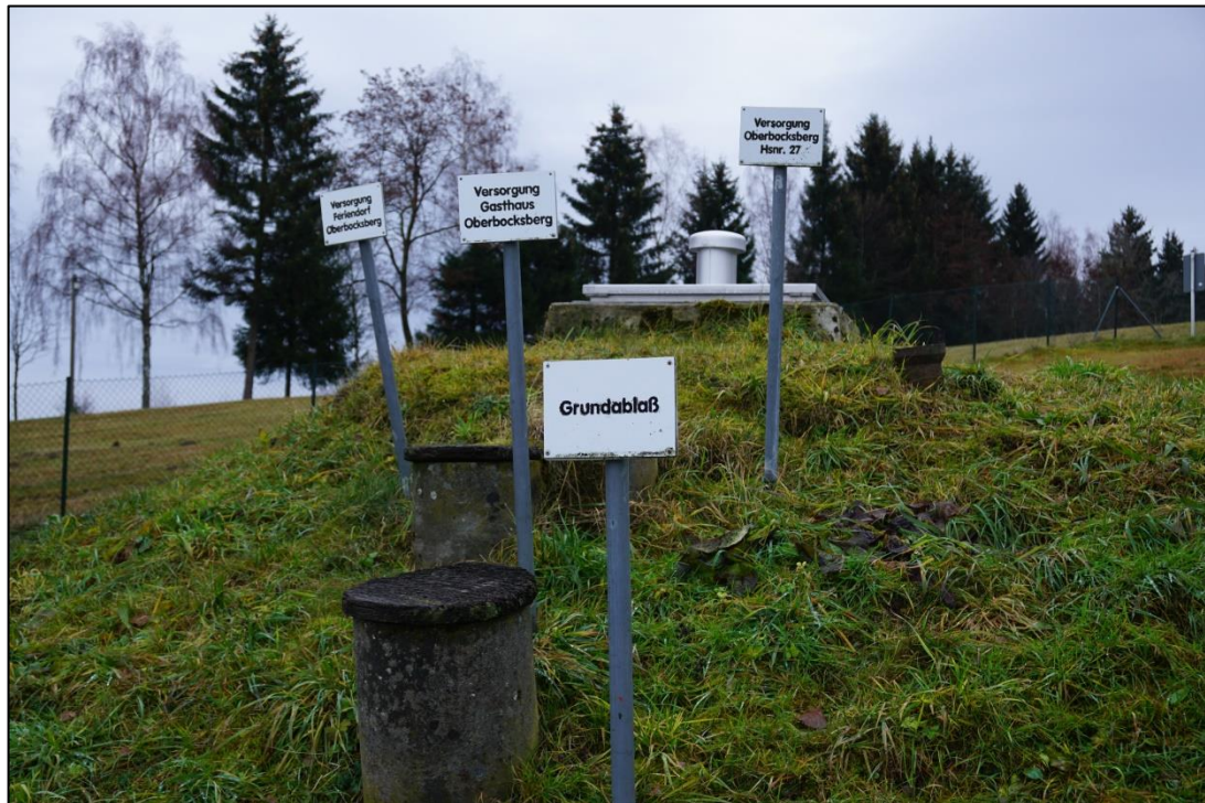
Bild 2: Markierung Schieber für Umgehungsleitungen außerhalb des Hochbehälters
