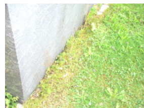
Durch den Bewuchs staut sich die Nässe.
